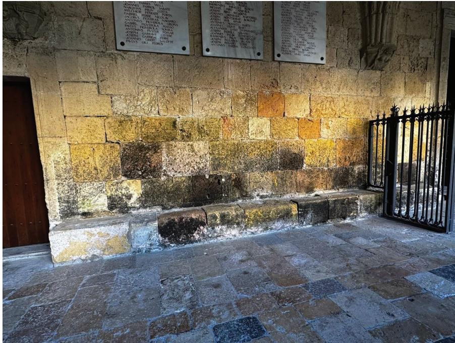
Figura 5. Foto de las humedades en el exterior del muro del refectorio. Autoría Propia.
