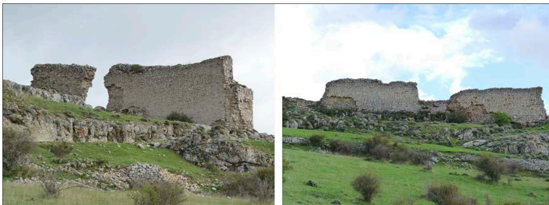
Figura 3. a. Tramo M1a del lienzo noroccidental de las murallas de Peñalcázar. b. Tramo M1b del lienzo noroccidental de las murallas de Peñalcázar.
