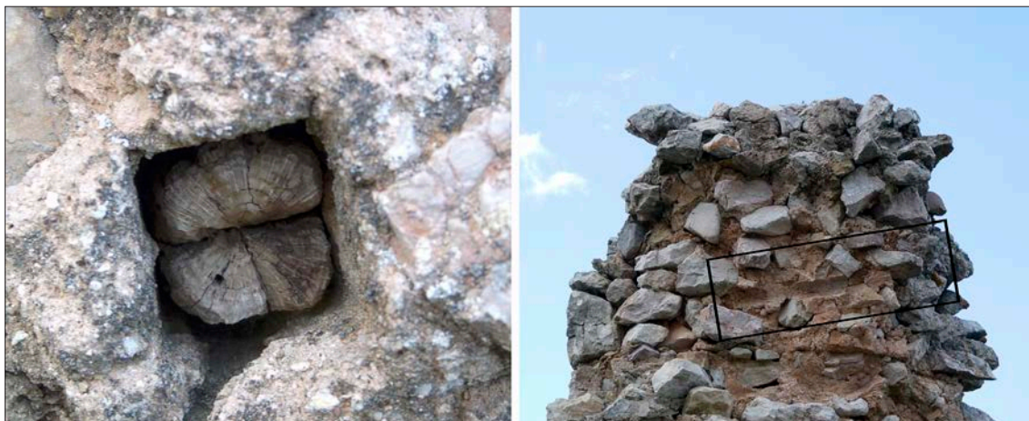
Figura 6. a. Detalle de una aguja de madera de sección cuadrangular conservada en el muro M2. b. Detalle de la cabeza del muro M2, en el que se advierte la huella inclinada de un codal o puntal interior.
