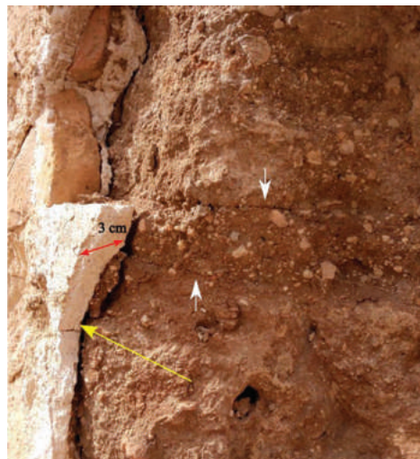
Figura 17. Tapia tipo 3, de la que se ha desprendido la costra de mortero (fotografía M. Sánchez). Se observa su grosor (flecha amarilla) y las líneas de tongadas del ánima de la tapia (flechas blancas)
