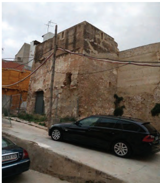
Figura 6. Estado de la torre-puerta del Pont del Vidre en noviembre de 2020, antes de la última intervención (archivo del Ayuntamiento de Llíria)
