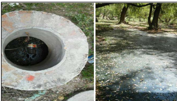
Ilustración 1. Alcantarilla y agua del río contaminada
