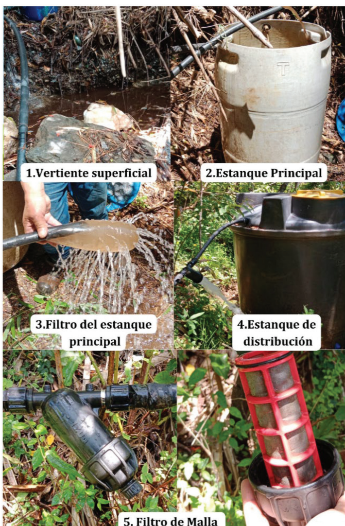
Figura 12. Abastecimiento de vertiente superficial por gravitación y filtros
