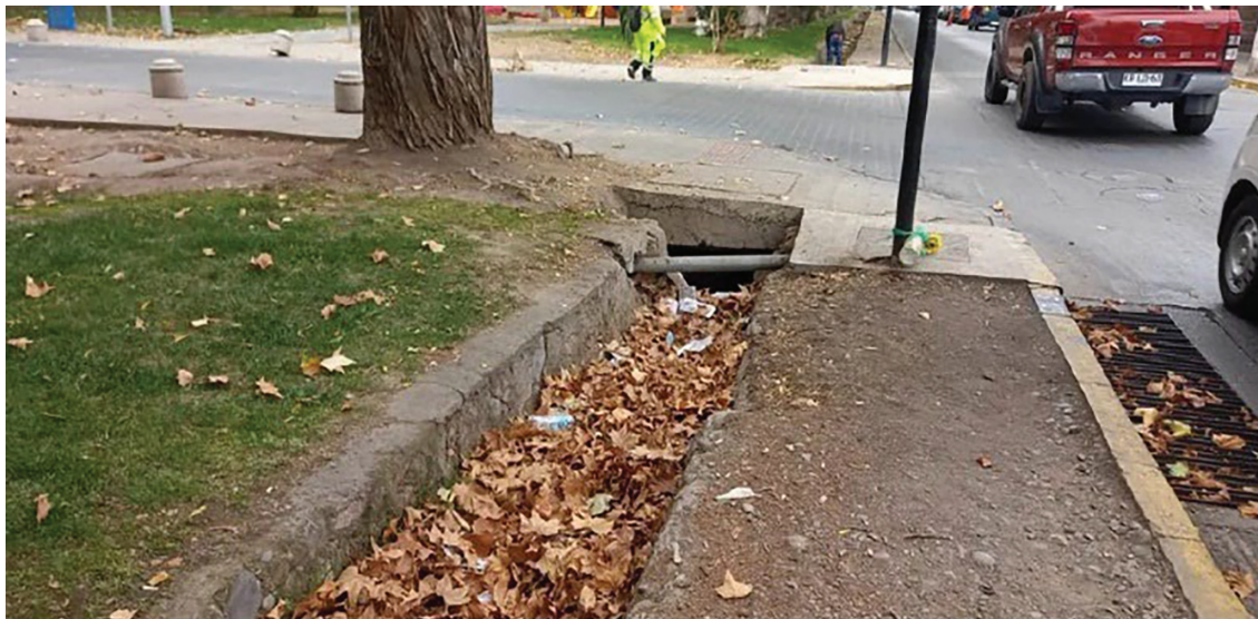
Figura 17. Acequia sanfelipeña rebozada de hojas de árbol, que afecta en el escurrimiento de su caudal, produciendo desborde de sus aguas en la época invernal, dañando tanto la propiedad pública como privada
