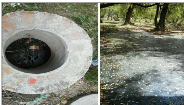
Ilustración 1. Alcantarilla y agua del río contaminada
