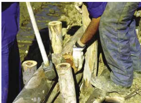
Figura 7. Instalación de empalizada de madera para estabilización de taludes (arriba) y esquema de la técnica (abajo)
