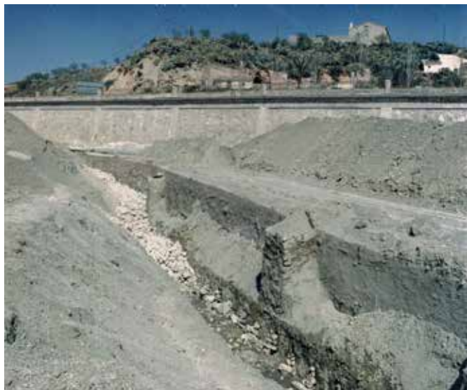
Figura 10. Limpieza del Contracaño en la rambla de Nogalte. Modelo de galería drenante antepuesta a presa subálvea
