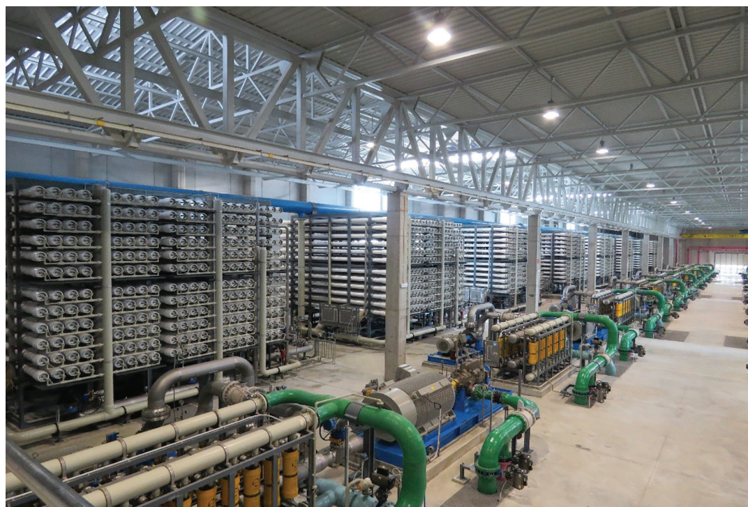
Figura 3. Bastidores de ósmosis inversa en la desaladora de Torrevieja (Alicante)
